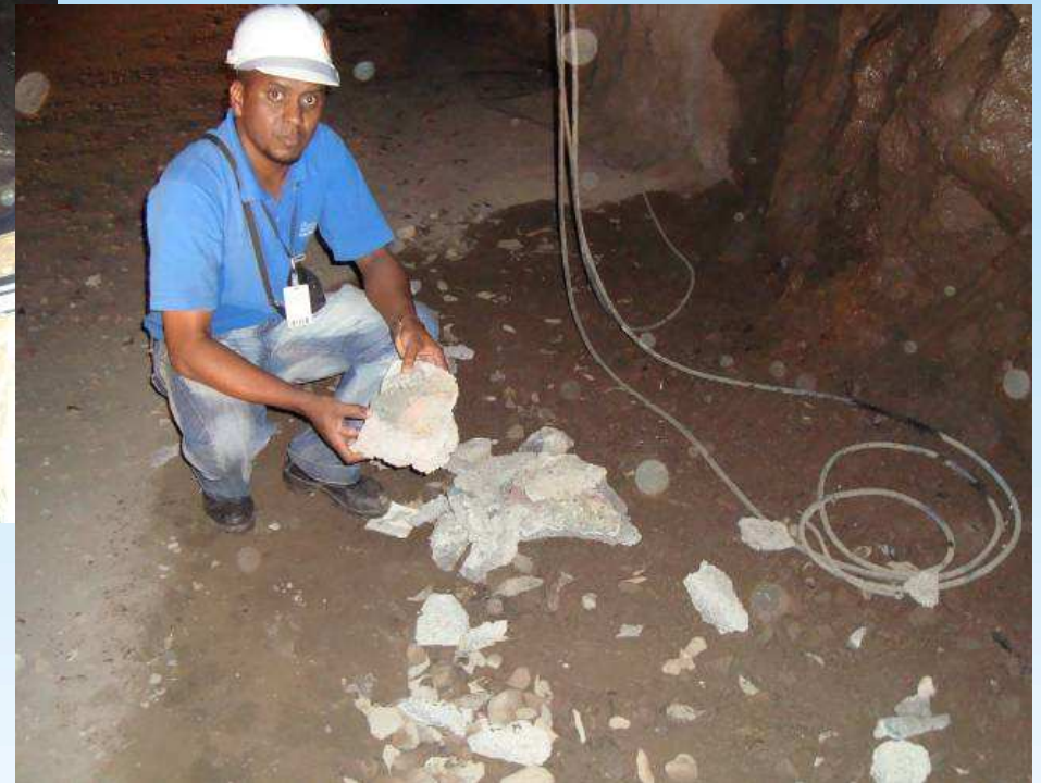
Deslocamento da gunita do teto, antes da instalação da tela.
