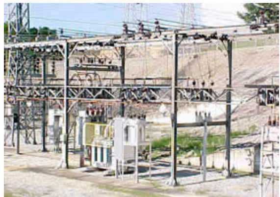
FIGURA 13: Dados e vistas dos transformadores.
