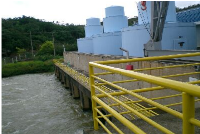
FIGURA 12: Canal de fuga e vista parcial dos geradores.
